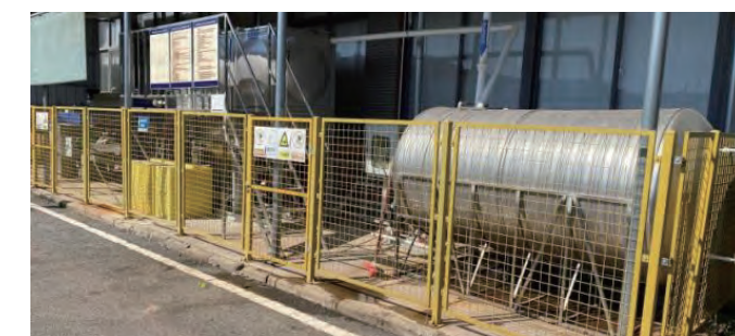
自建污水处理设施
